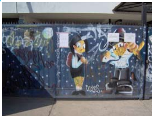
Foto 17 ANTES: Entrada a escuela impide visibilidad, está rayada y no identifica positivamente a la escuela.
