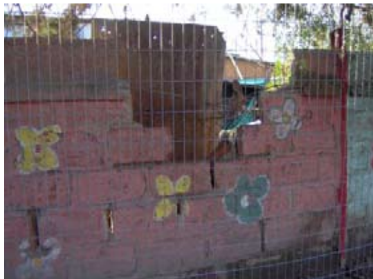
Foto 7 ANTES: Muro en mal estado que podía provocar accidentes.
