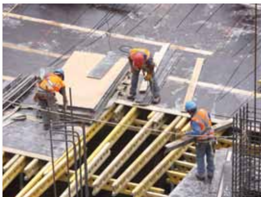
Cuerda de vida como elemento de protección colectiva.
